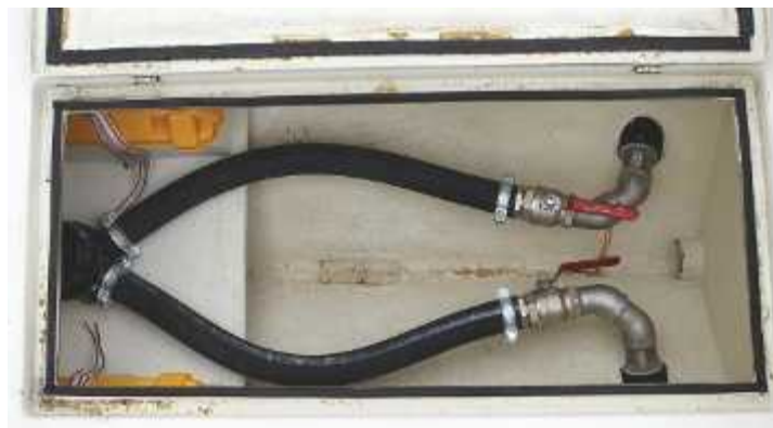
Missä tavallisesti olisi tunneli ja keulapotkurin moottori, on nyt kaksi runkoläpivienttiä ja letkut venttiileineen. Kuvassa näkyvät myös kaksi 12 voltin akkua, joista syötetään virta pumpulle, joka tässä tapauksessa käyttää 24 voltin jännitettä.
